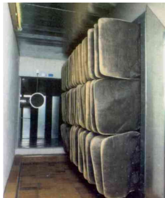
Bild 3: Taschenfilter und Schalldämpfer (Referenzanlage: BVA-Büro- und Ambulatoriumsgebäude, Graz)
